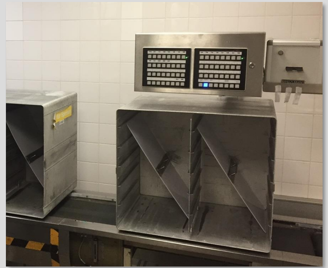
Neue Bedienstation mit OM 2032
